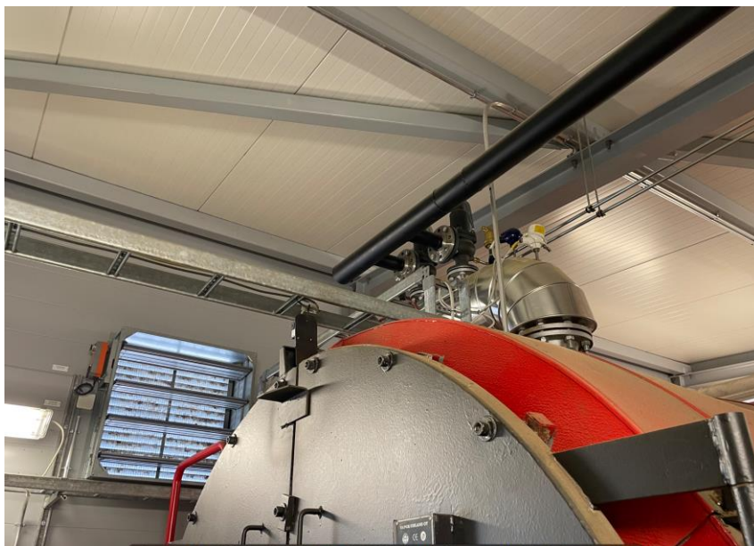
Kuva 36. Teholtaan 3,0 MW tulitorvituliputkikattila (Vapor) varustettuna Oilonin polttimella ja öljyn pumpauskeskuksella.
