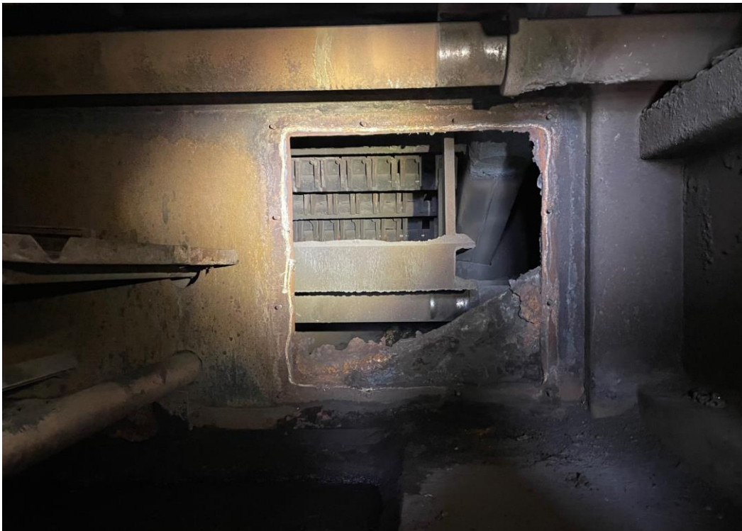
Kuva 20. Kuva arinan alta kattilan pohjapäädystä.
