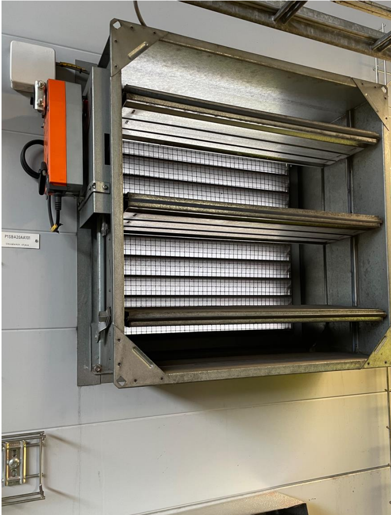
Kuva 25. Ison kattilahallin tuloilmasäleikkö toimilaitteineen
