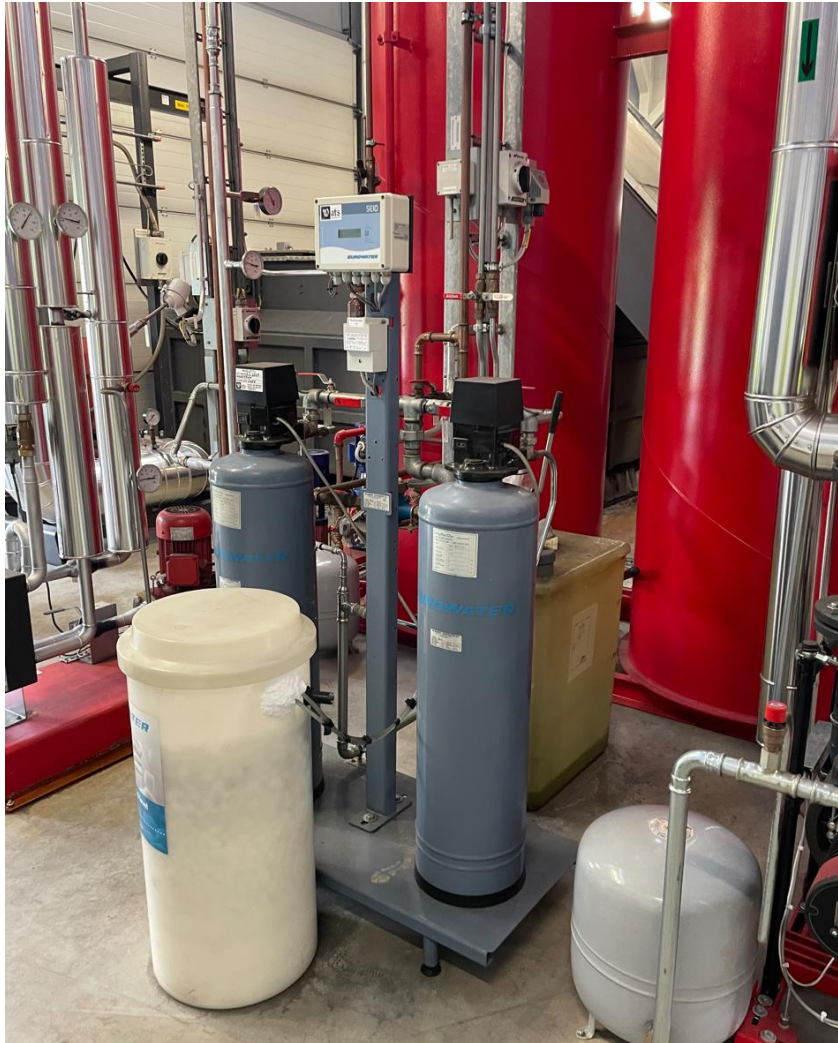
Kuva 32. Taustalla kaksi isompaa paisuntasäiliötä punaisella. Edessä vedenpehenninyksikkö. Oikealla kattilahallin omakäyttöpiirin pumppu ja kalvopaisuntasäiliö (harmaa).
