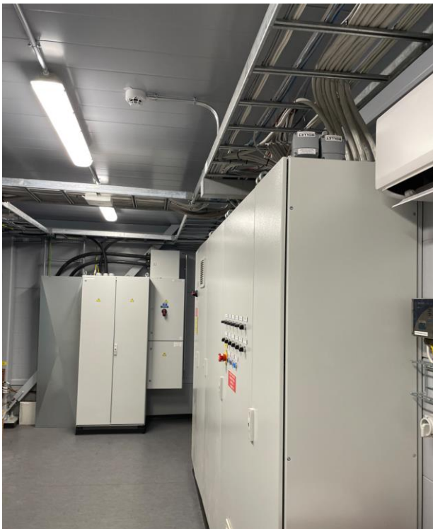
Kuva 34. Sähkö- ja automaatiotila
