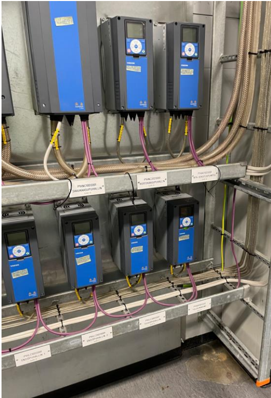
Kuva 35. Taajuusmuuttajat sähkötilassa selkeästi positioituna
