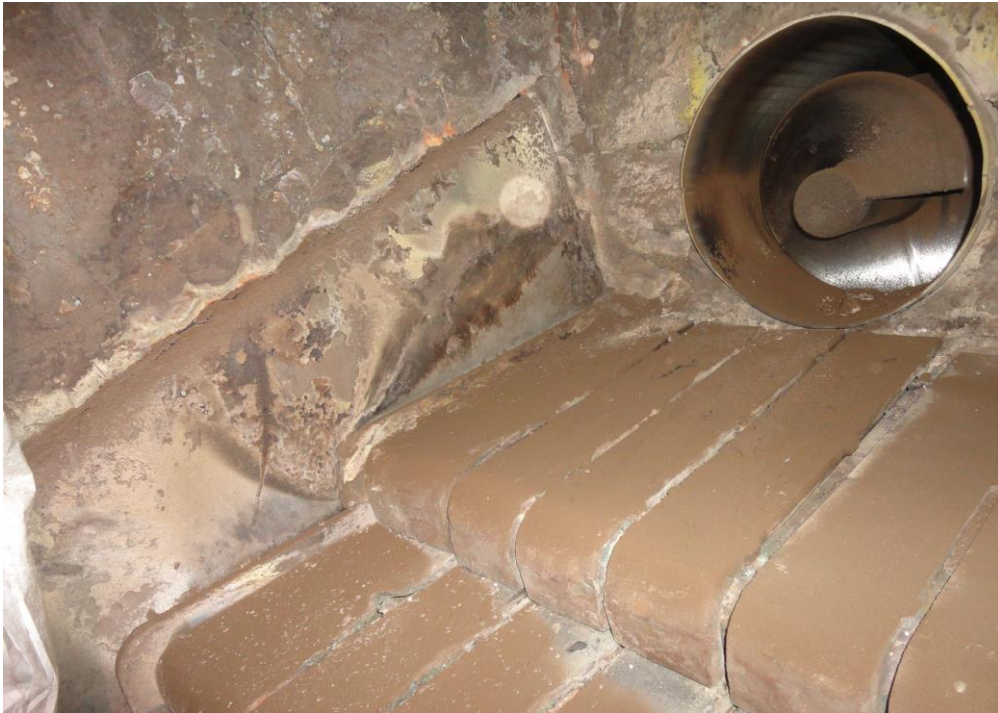
Kuva 15. Syöttö arinalle stokeriruuvilta
