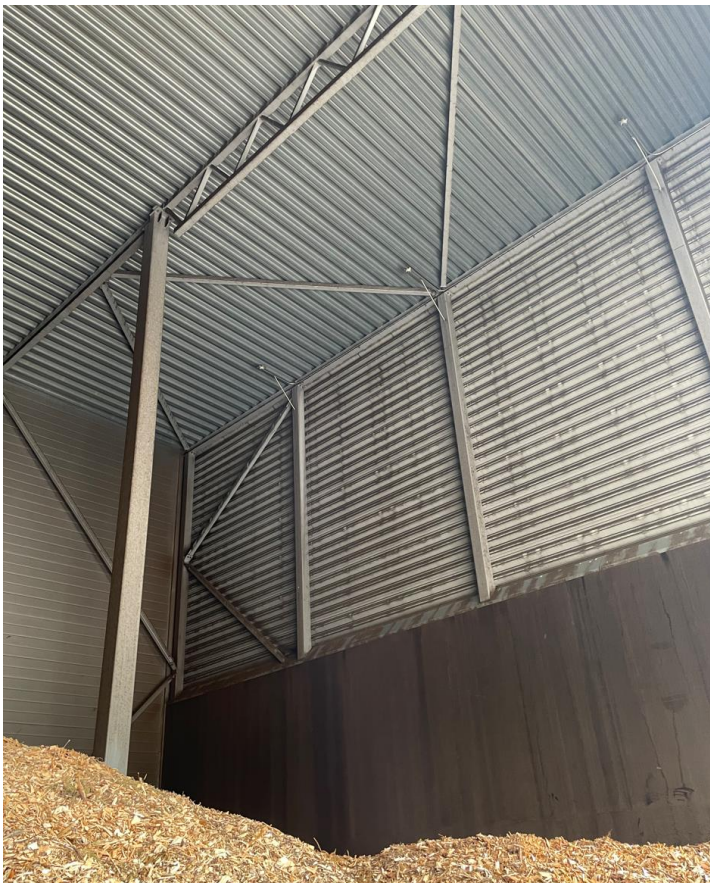
Kuva 1. Varaston sisäseinä- ja kattorakenteet sekä seinän filmivanerointi, jonka tarkoitus on estää polttoainekerroksen holvaantuminen.
