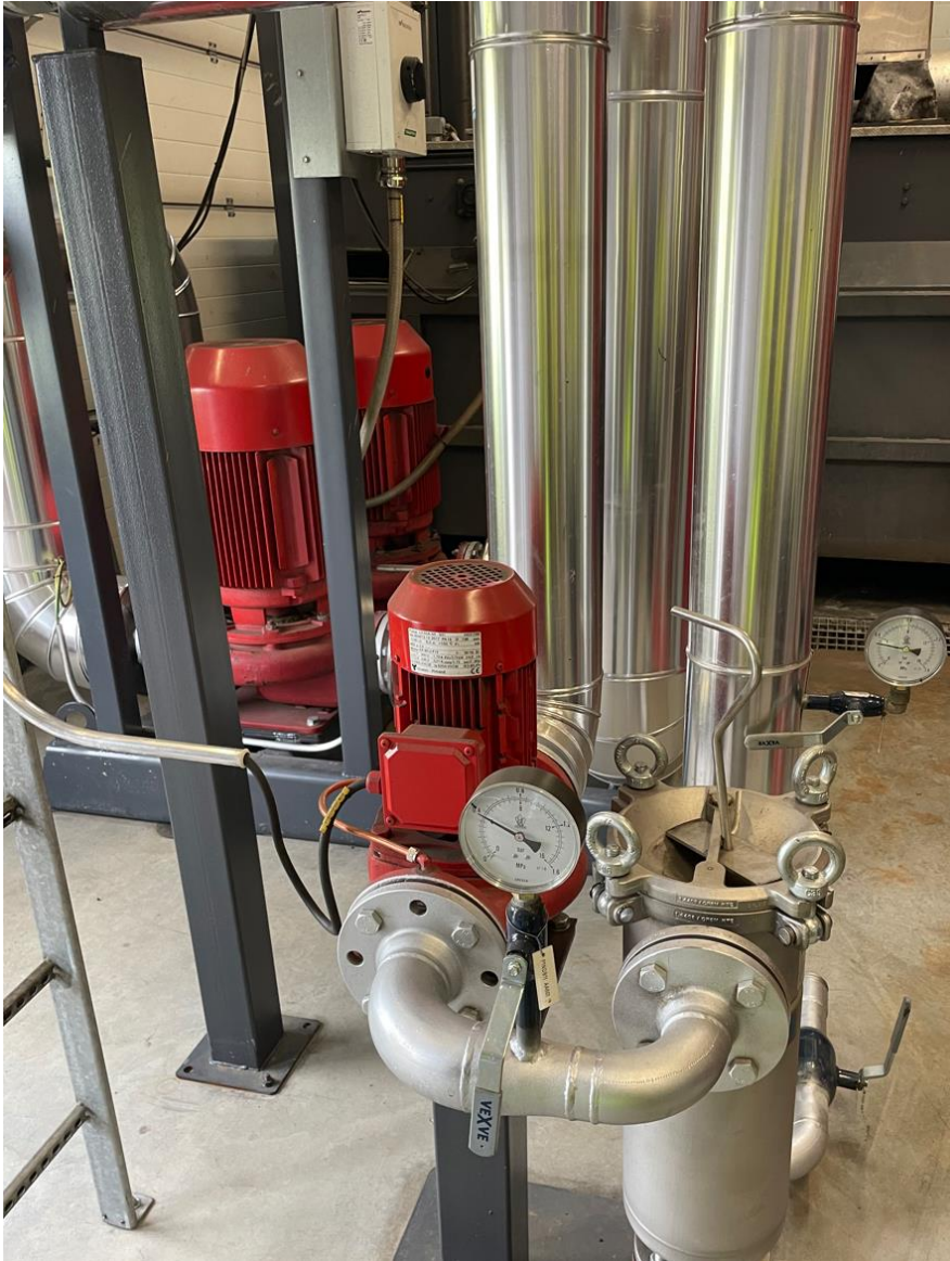
Kuva 30. Kaukolämpöpumput 2 kpl taustalla, edessä sivuvirtasuodatin omalla kiertopumpulla kaukolämpövedelle.
