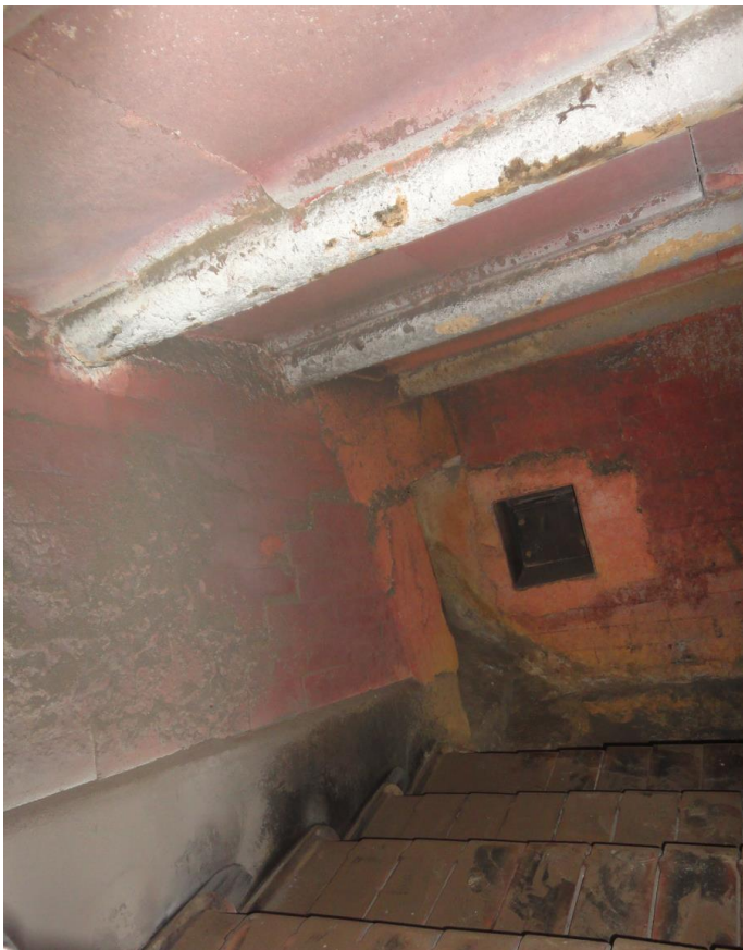
Kuva 16. Arinan alaosa, josta tuhka putoaa märkätuhkakuljettimelle
