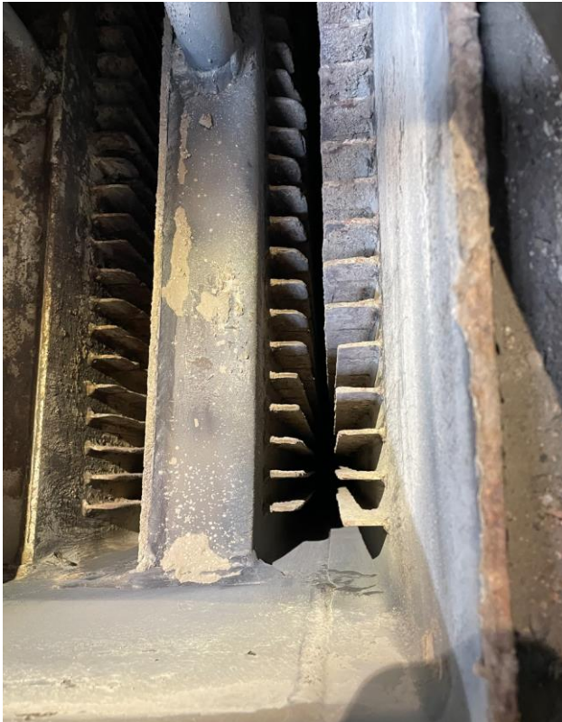
Kuva 22. Kattilan päältä, konvektio-osan viimeinen veto ennen kaasun virtausta multisyklonille
