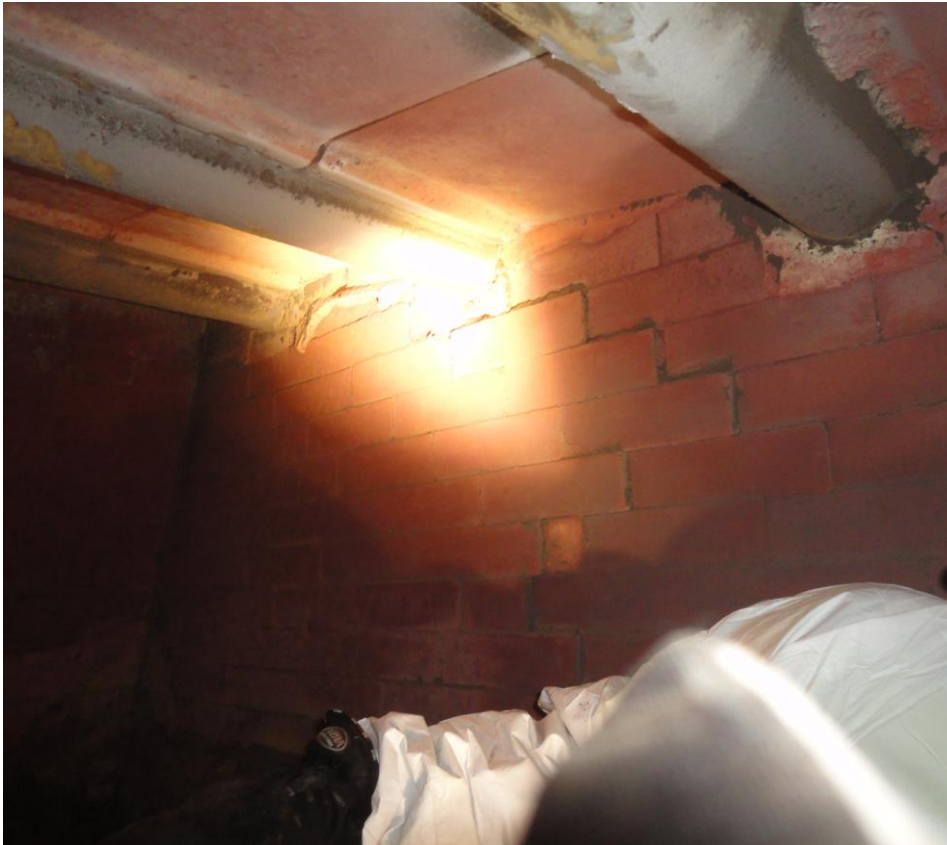
Kuva 11. Muuraukset konvektio-osan alta ja arinan alapäästä lähellä kohtaa, jossa palamaton tuhka puutoa märkätuhka-altaaseen
