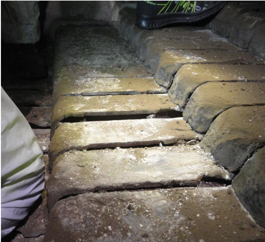
Kuva 17. Muutama arinarauta uusimisen tarpeessa.
