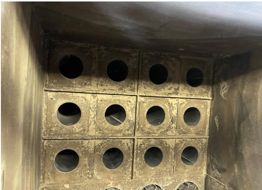
Kuva 27. Kuva multisyklonin sisältä, päältä kuvattuna, huoltoluukun ollessa avoinna.
