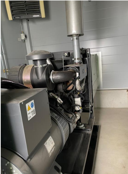
Kuva 37. Varavoimakone 105 kVA, varakattilalaitosrakennuksen omassa huonetilassa
