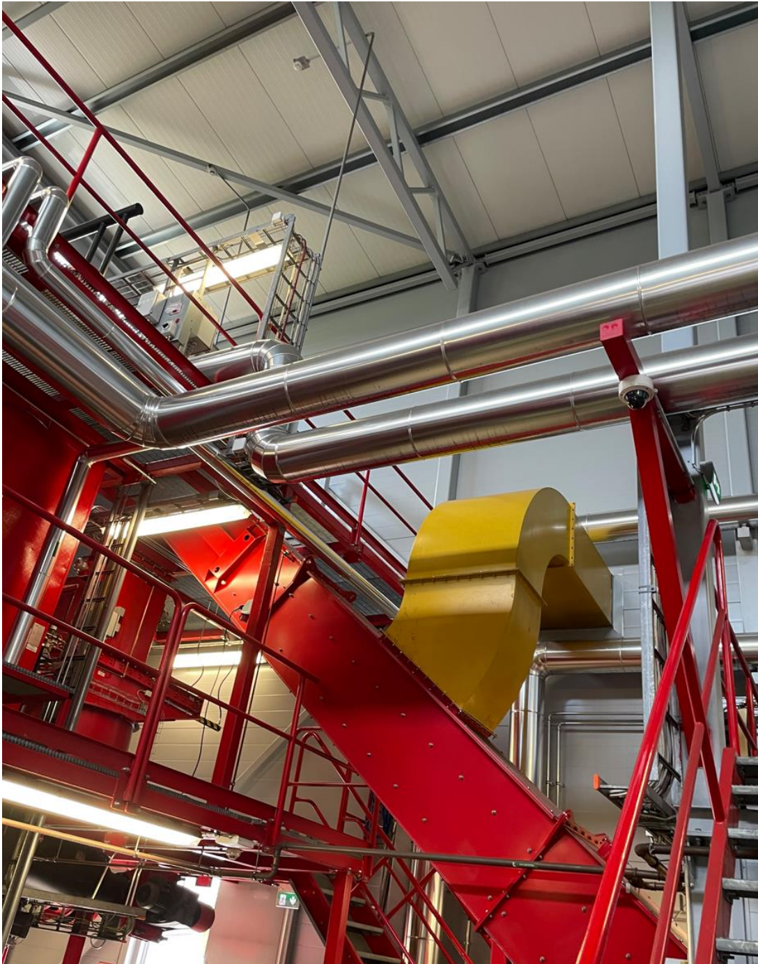
Kuva 31. Putkisto on rakennettu ja kannakoitu asiallisesti kauttaaltaan kaikkien putkien ja kanavien osalta. Keltaisella näkyy kolakuljettimen räjähdysluukun kanava ulos rakennuksesta. Toinen vastaava on polttoainevarastossa kuljettimen alaosassa.
