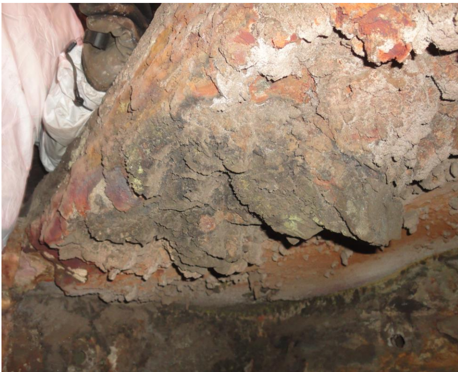
Kuva 18. Arinan stokeripäädyn yläpään ”lippa”, jossa normaalia iän tuomaa karstoittumista, jonka vaikutus kattilan toimintaan ja hyötysuhteeseen on mitätön
